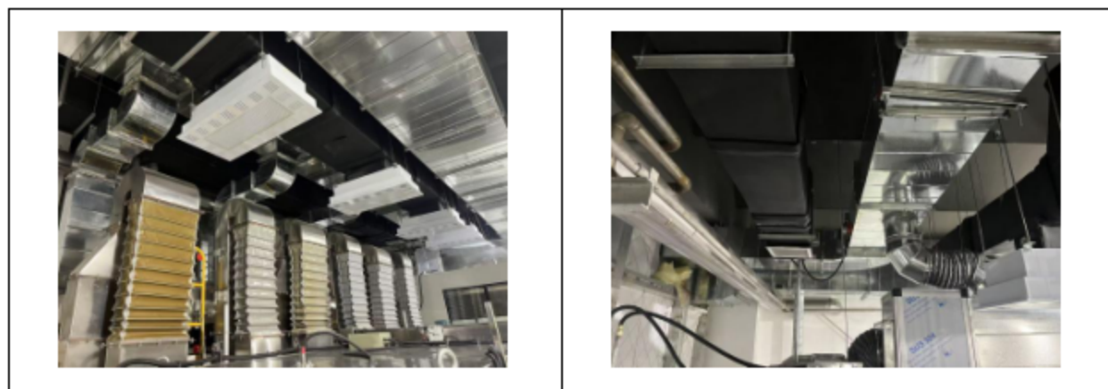
图 4.1-6 装置废气密闭收集设施现场照片
