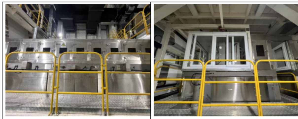
图 3.6-2 主要生产装置现场照片
